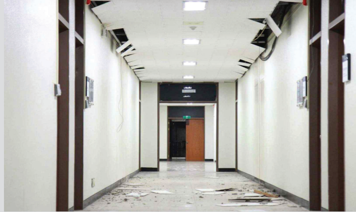
포항 지진으로 대한민국의 오래된 건물이 지진에 취약하다는 인식이 널리 퍼졌다. <출처: KPUG>
