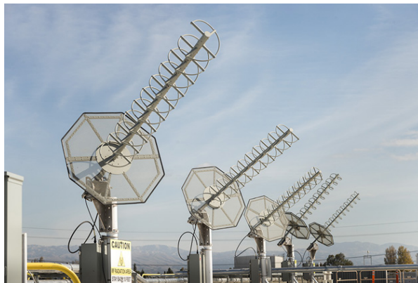
MUOS 무선시험 접속시설(TRAF)
